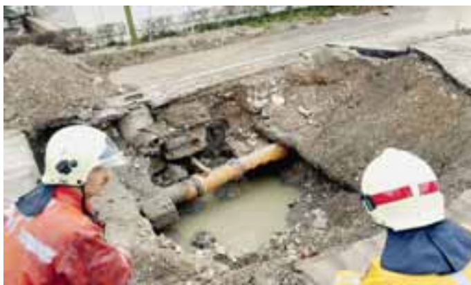
Strassenschäden durch Werkleitungen: Muss eine Kantonsstrasse geöffnet werden, wie hier wegen eines Rohrbruchs oder wegen Sanierungsarbeiten, saht der Kanton neuerdings ab. Bild: ky
